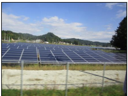
相馬郡飯舘村の太陽光発電(車窓から)
