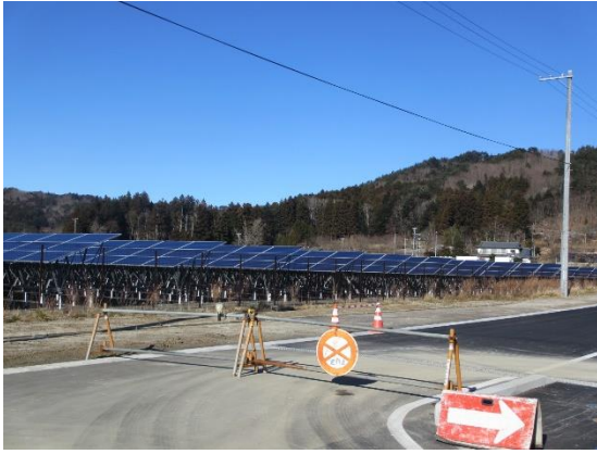
いいたて村・道の駅「までい館」の隣りに設置されている太陽光発電パネル
